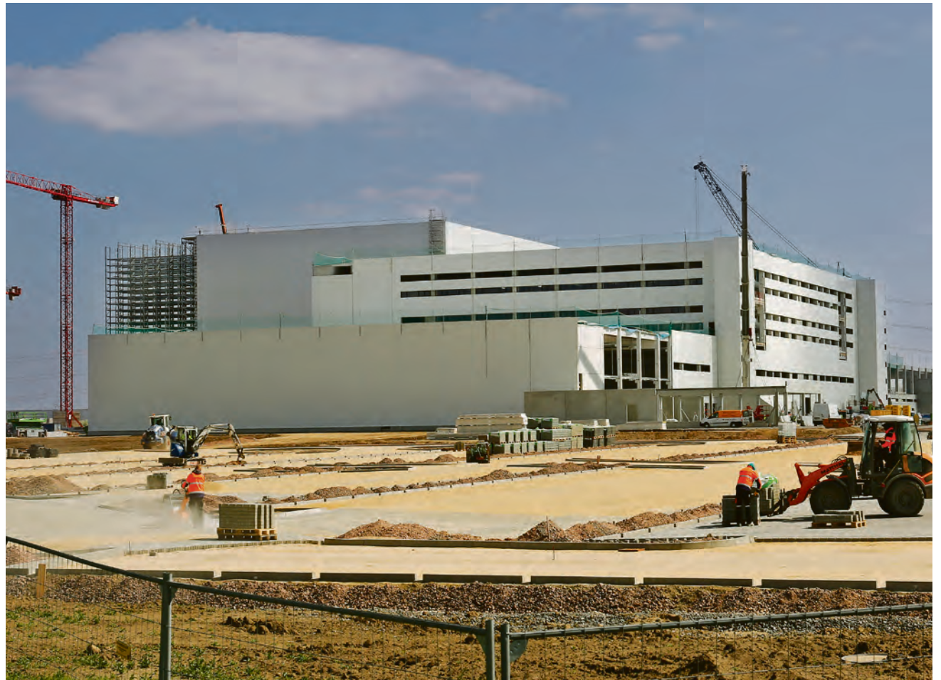
Der Automobilzulieferer Schaeffler baut derzeit im Star Park ein 40 000 Quadratmeter großes, modernes Montage- und Verpackungszentrum. Rund 900 Arbeitsplätze sollen entstehen. Die Inbetriebnahme ist für Anfang 2020 geplant. Foto: Thomas Ziegler
