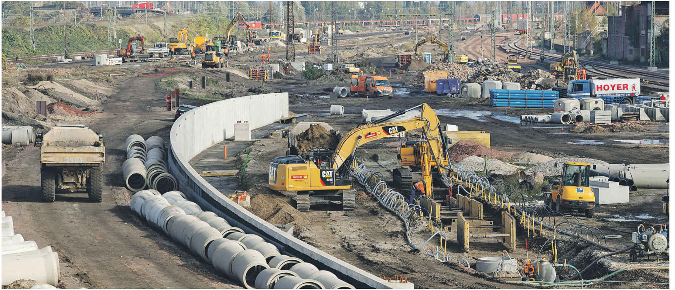
Blick von der Berliner Brücke: Die Deutsche Bahn baut in Halle (Saale) einen der modernsten Bahn-Knotenpunkte Europas. Bis zum Jahr 2017 entsteht eine neue Zugbildungsanlage. Gleise, Oberleitungen, Brücken, Stellwerke und Bahnsteige werden saniert. Der Umbau schließt den Anschluss an die ICE-Trasse Berlin-München ein. Von Berlin über Halle (Saale) nach München werden künftig weniger als 3,45 Stunden Reisezeit benötigt.
