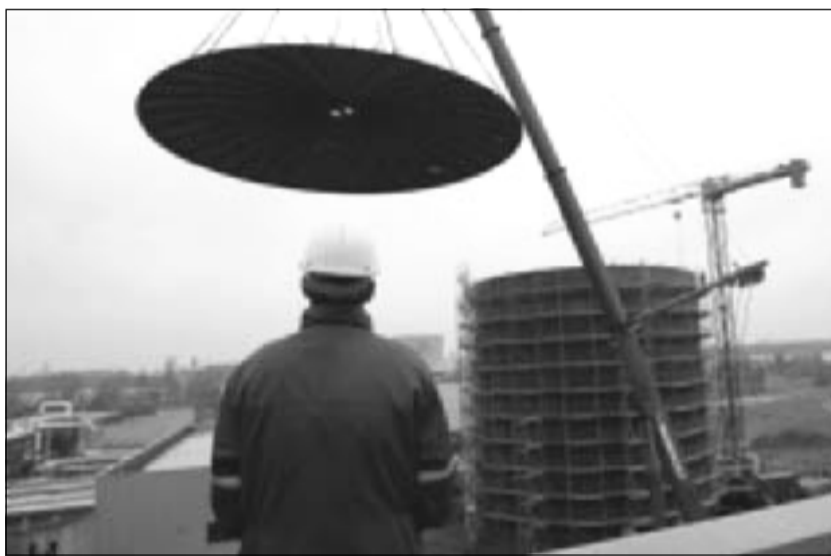
Einen 30 Tonnen schweren „Deckel“ setzten am Mittwoch, dem 12. April, die Bauleute im Gelände des Kraftwerkes Dieselstraße auf den neuen Fernwärmespeicher. Foto: J. Schlüter
