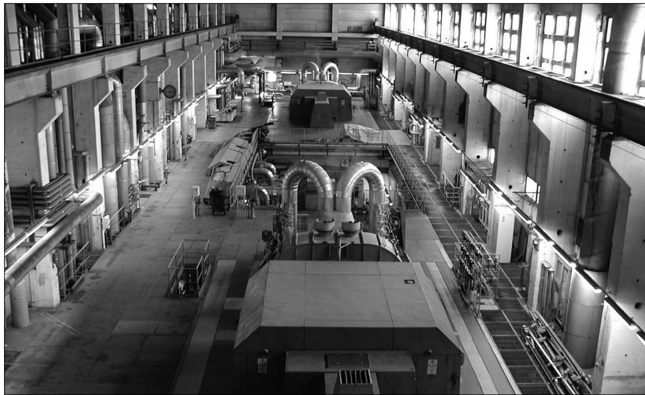
Blick in die Werkhalle des Kraftwerks Dieselstraße – zum „Tag der offenen Tür“ möglich.
